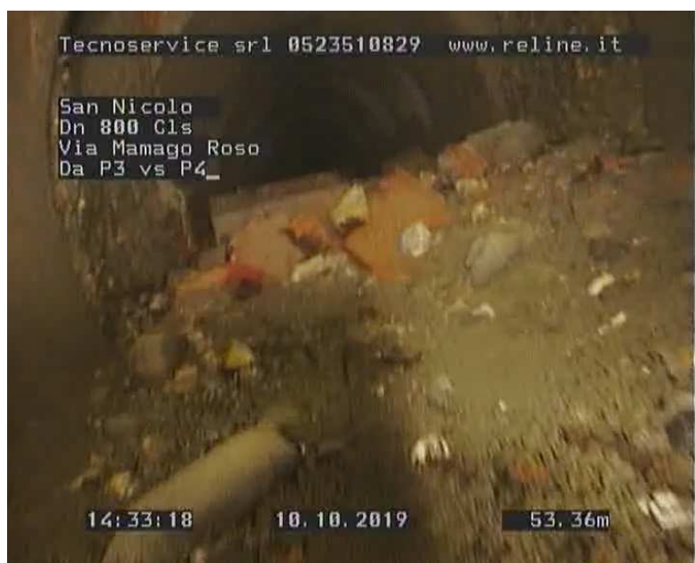
Una delle ostruzioni riscontrate con la videoispezione
