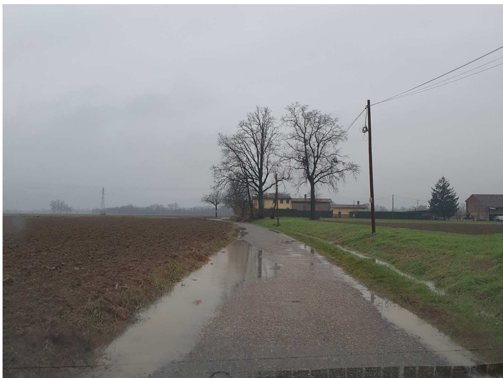
I ricorrenti allagamenti della sede viabile lungo la strada comunale della Bonina
