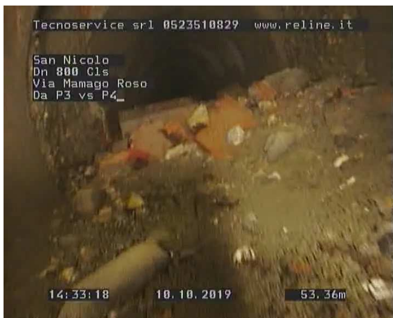
Una delle ostruzioni riscontrate con la videoispezione
